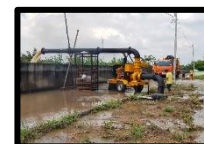
จุดที่ 3 ติดตั้งเครื่องสูบน้ำขนาด 12 นิ้ว อ.ป่าโมก จ.อ่างทอง
