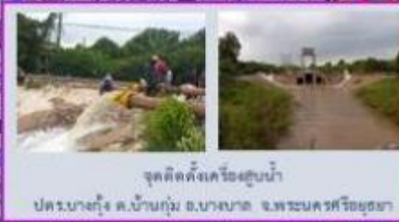
จุดติดตั้งเครื่องสูบน้ำ ปตร.บางกุ้ง ต.บ้านกุ่ม อ.บางบาล จ.พระนครศรีอยุธยา
