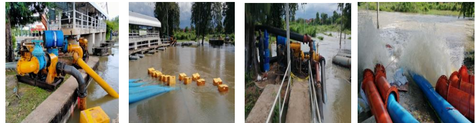
เครื่องผลักดันน้ำและเครื่องสูบน้ำที่ติดตั้งในลำบริบูรณ์และลำตะคอง
