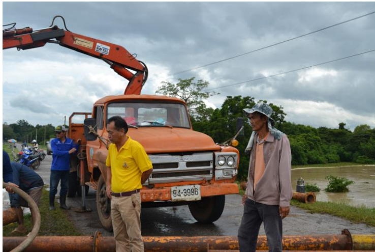
ส่วนเครื่องจักรกล สขบ.6 และโครงการฯ กาฬสินธุ์ ทำการติดตั้งกัลก้น้ำขนาด \varnothing 8 นิ้ว บริเวณอ่างฯ ห้วยสีทน
