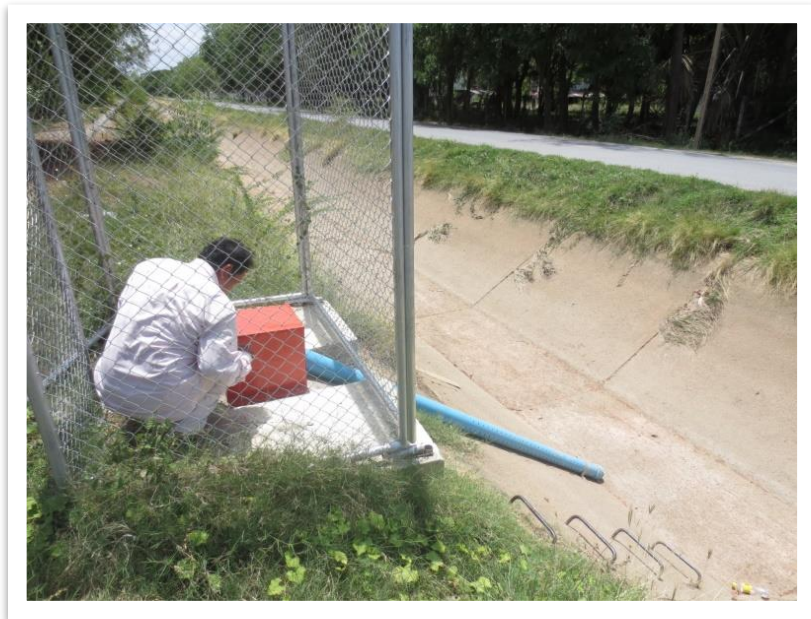
รูปที่ 19 การติดตั้ง sensor เปรียบเทียบแรงดันน้ำ ที่ฝ่ายส่งน้ำที่ 4 อุโมง
