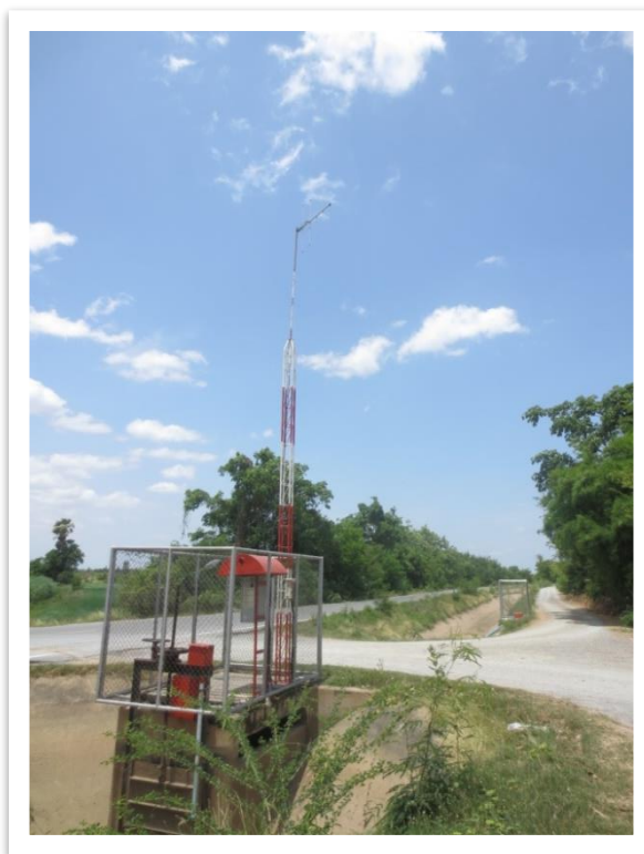
รูปที่ 18 การติดตั้ง sensor วัดระยะการปรับบานประตูระบายน้ำ
