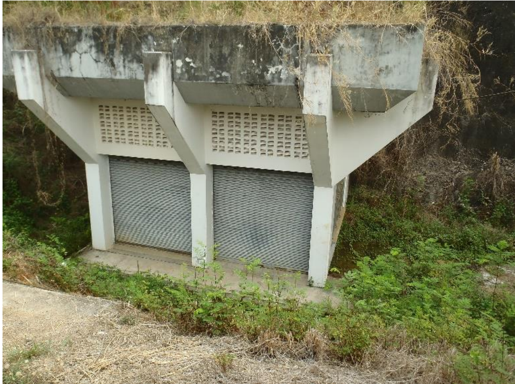
รูปที่ 3-8 อาคารปากคลองจากท่อ OUTLET ของคลองส่งน้ำสายใหญ่ฝั่งซ้ายของฝ่ายส่งน้ำและบำรุงรักษาที่ 3
