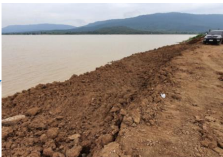
การถมดินเพิ่มบริเวณลาดเขื่อนด้านเหนือน้ำ
