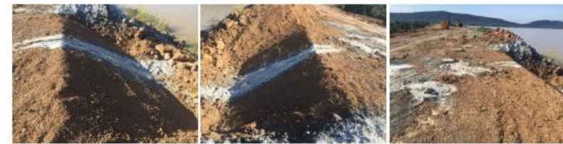
สภาพรูโหว่ บริเวณ กม.2+260
