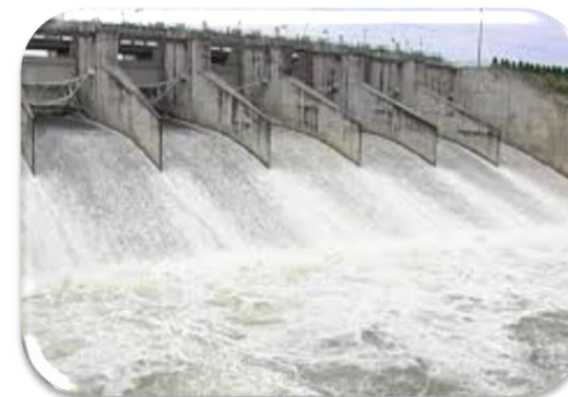
ไม่สามารถระบายน้ำได้สะดวก
